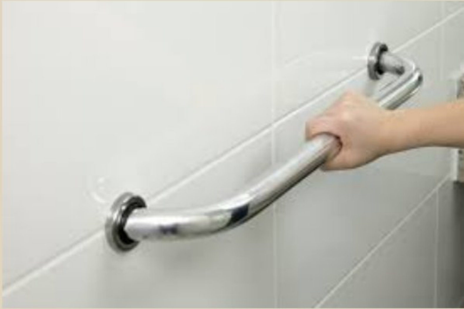
Barra de apoio no box
